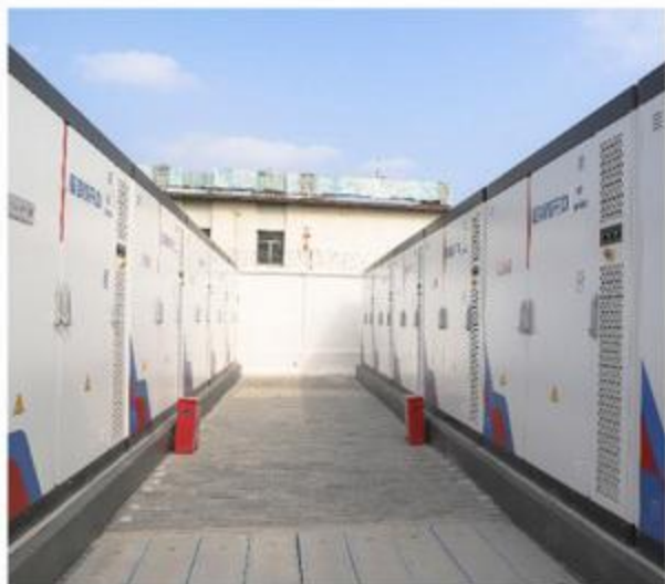
中开新能源赤湾片区储能电站项目
